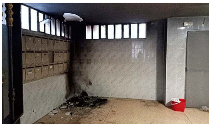
Estado de los buzones de este bloque de viviendas. E. M.
